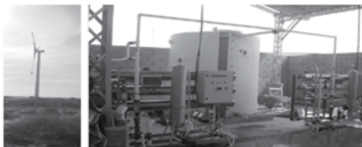
Planta desalinizadora y potabilizadora del parque eólico Jepírachi-EPM comunidad indígena de Kaswuarin. Fotos cortesía Eugenio Balduzz. Gerente ECOSESTO Ltda.
