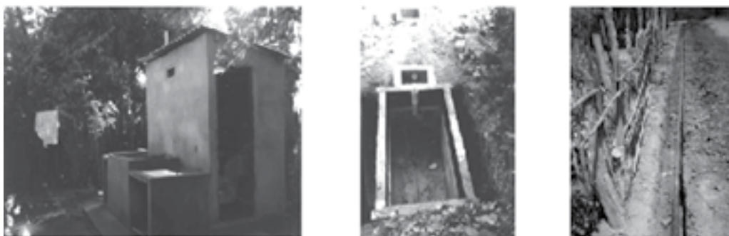
Alcantarillado ASAS en la vereda Cacicazgo de Suesca
