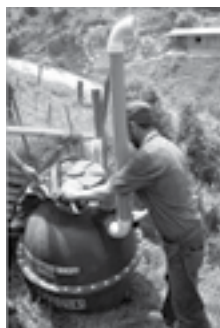
Solución individual para tratamiento de aguas residuales domésticas en el barrio Nueva Esperanza desarrollada por la Secretaría de Salud de Bogotá.
