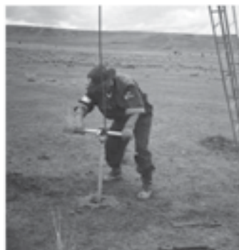
Operación manual de la bomba
