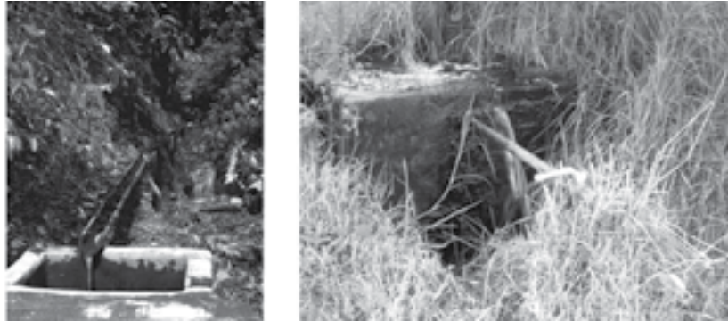
Captación de agua superficial por gravedad
